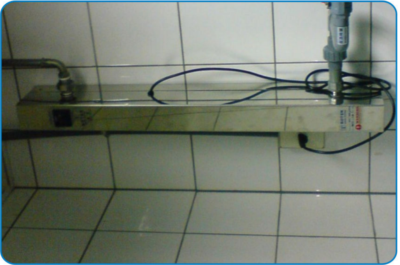
紫外線安裝現況
