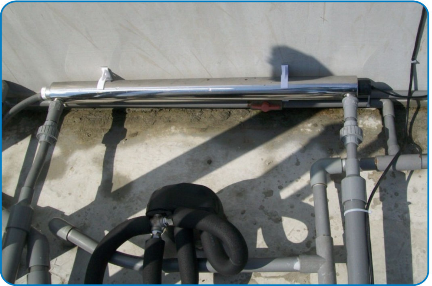
紫外線安裝現況
