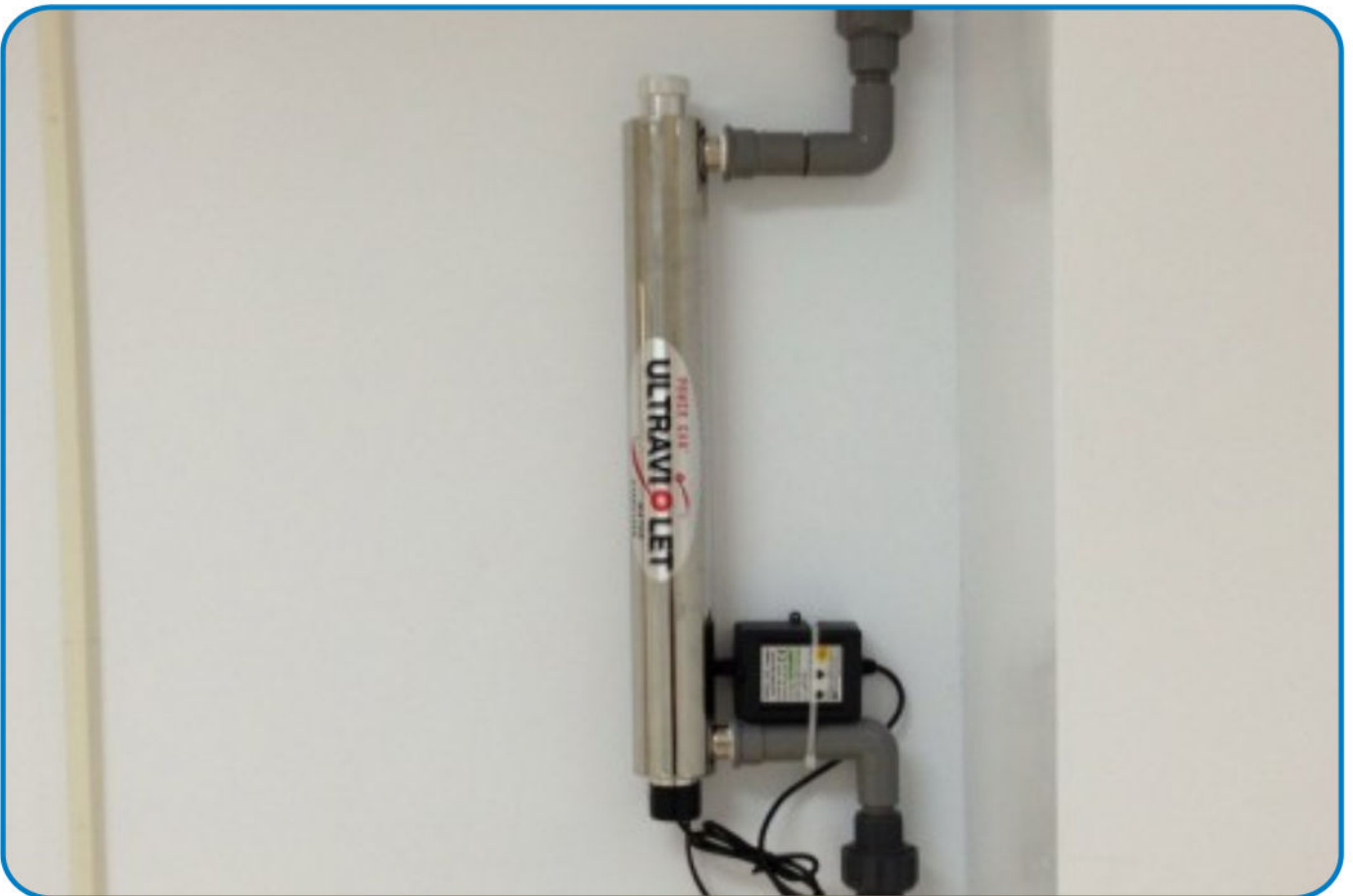
紫外線安裝現況
