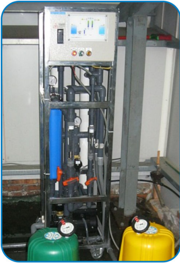
UF機安裝現況
